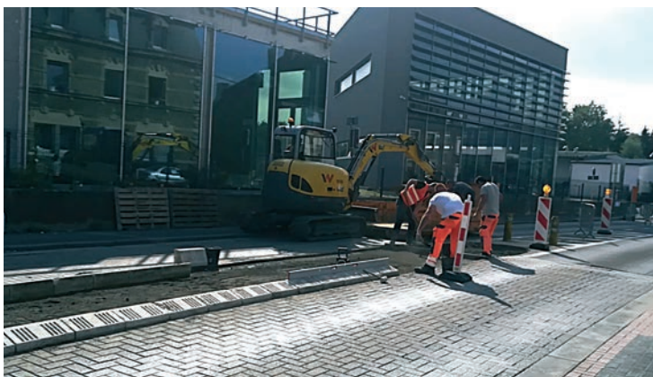
Travaux de rénovation des îlots de la rue de Rodange à Athus. Remplissage avec des pavés autobloquants.
